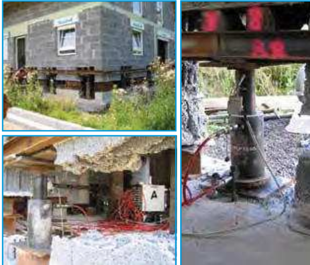
Levage synchrone avec Synchronlift pour la reconstruction des fondations d'une maison. (Allemagne 2003)
